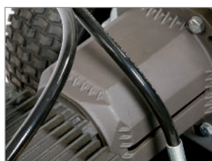
ELASTYCZNE SPRZĘŁO POMIĘDZY POMPA A SILNIKIEM
